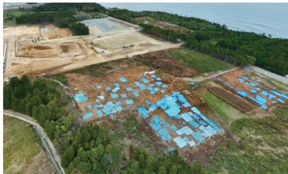
浪江町牧場建設地 (上段は造成工事中、下段は文化財発掘中)
