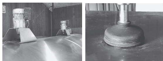
（アジテーターシャフト基部）
