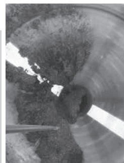
△カビのついたタンク例 一度ついてしまうと除去作業は本当に大変です。
